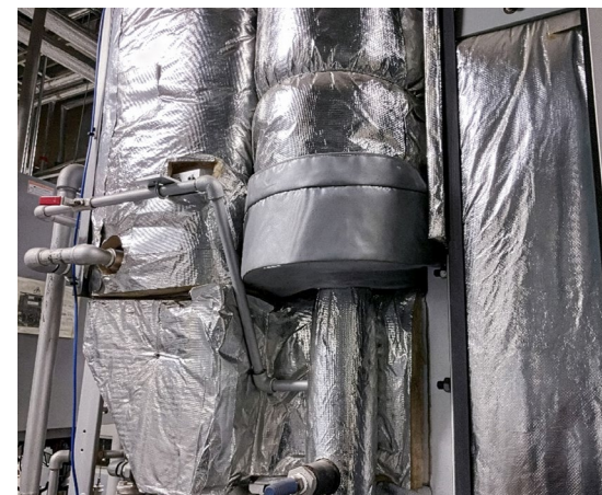
シルバーの保温材で配管を覆っている様子
